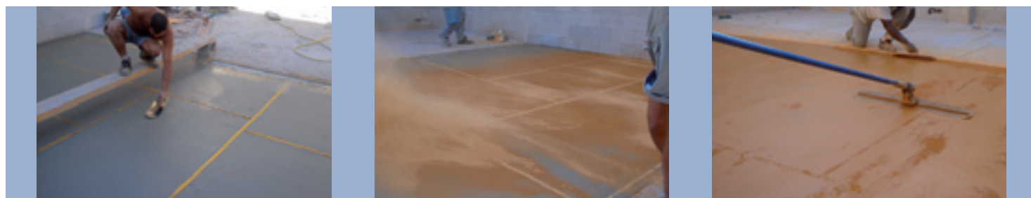
Alisado y extendido del hormigón en fresco. Distribución e introducción de plantillas con la lana de hormigón.
